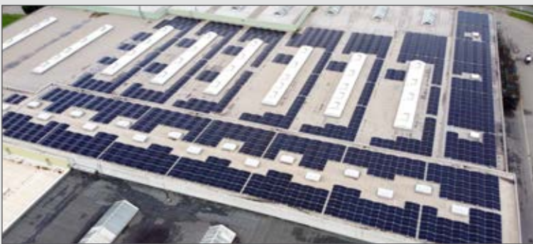
PV-Anlage am Standort Isny
